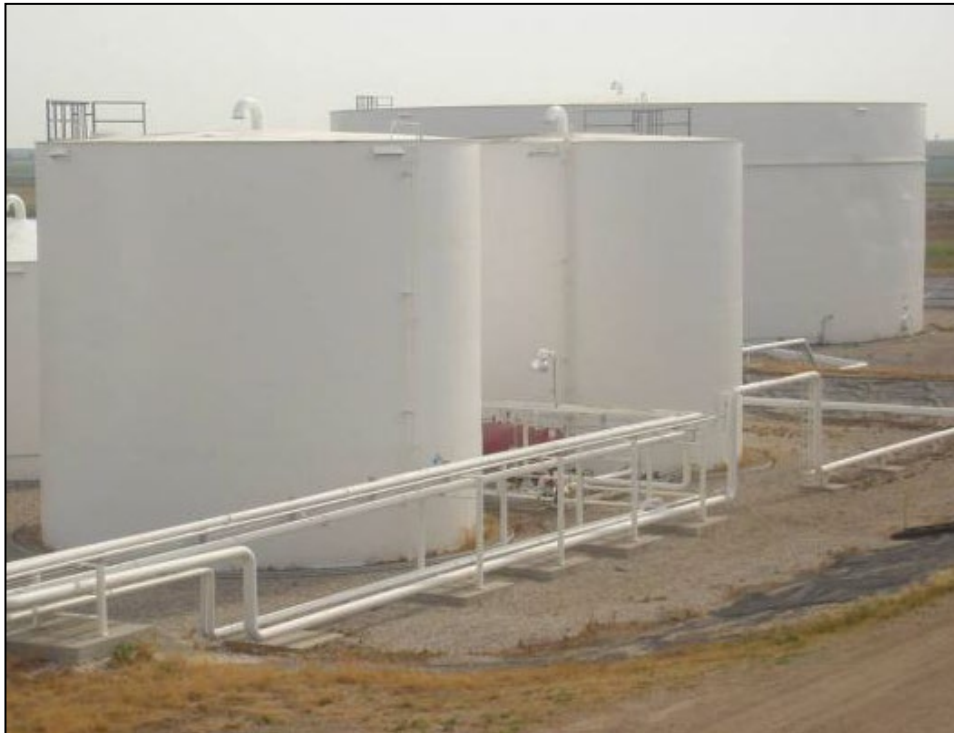
Figura 5.1: Tanque de almacenamiento con techo flotante interno
